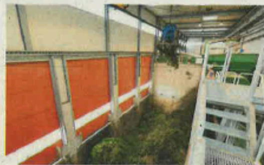
Verarbeitung von Grüngut in einer Kompogasanlage
